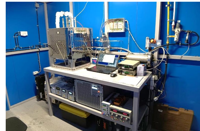
Стендовая установка для длительных испытаний ТОТЭ на метаноле
